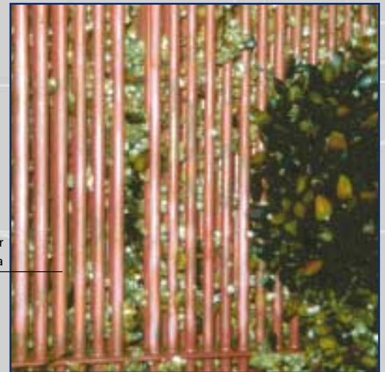
Tubos bloqueados por incrustación biológica
